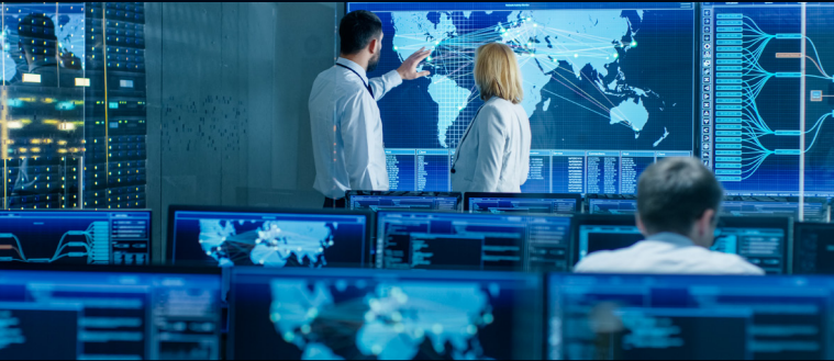
KONTROLLRÄUME Videowandsteuerung & KVM
